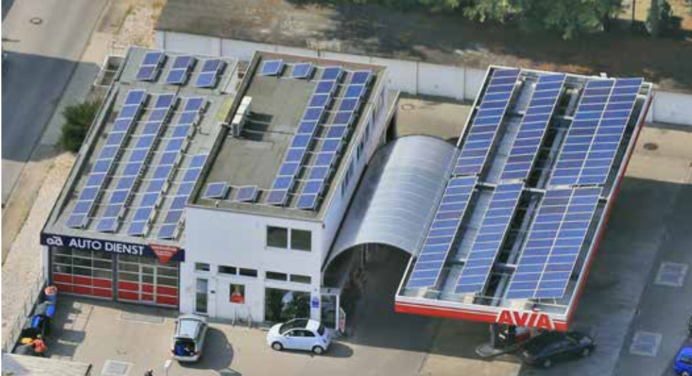
Tankstelle in Gelsenkirchen, 41,6 kWp, Inbetriebnahme 2014
