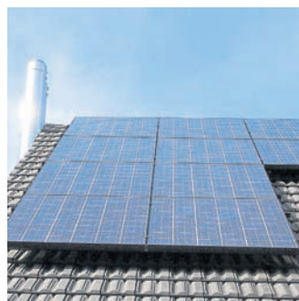
Strom für das Büro kommt vom eigenen Dach.
